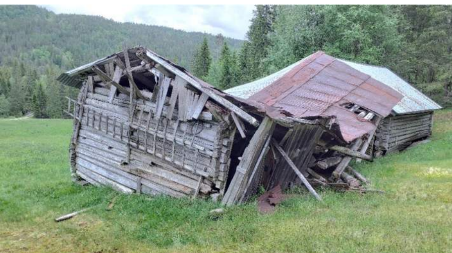
Figur 4-26: Denne driftsbygningen har gått fra intakt 1. omdrev til tapt i 6. omdrev. Kategorien driftsbygninger i tunet har størst akkumulert tap (Bø %) og årlig tapsandel (1,3 %) i 6. omdrev i Bø. Dette er en trend som sees i mange av de registrerte kommunene. Endringer i landbruket krever nye og tidsmessige driftsbygninger. De gamle tømmer for funksjoner og står for fall. Dette er store bygninger som er kostnadskrevende å vedlikeholde. Foto: AR/ASPLAN VIAK 2025 (165694570)
