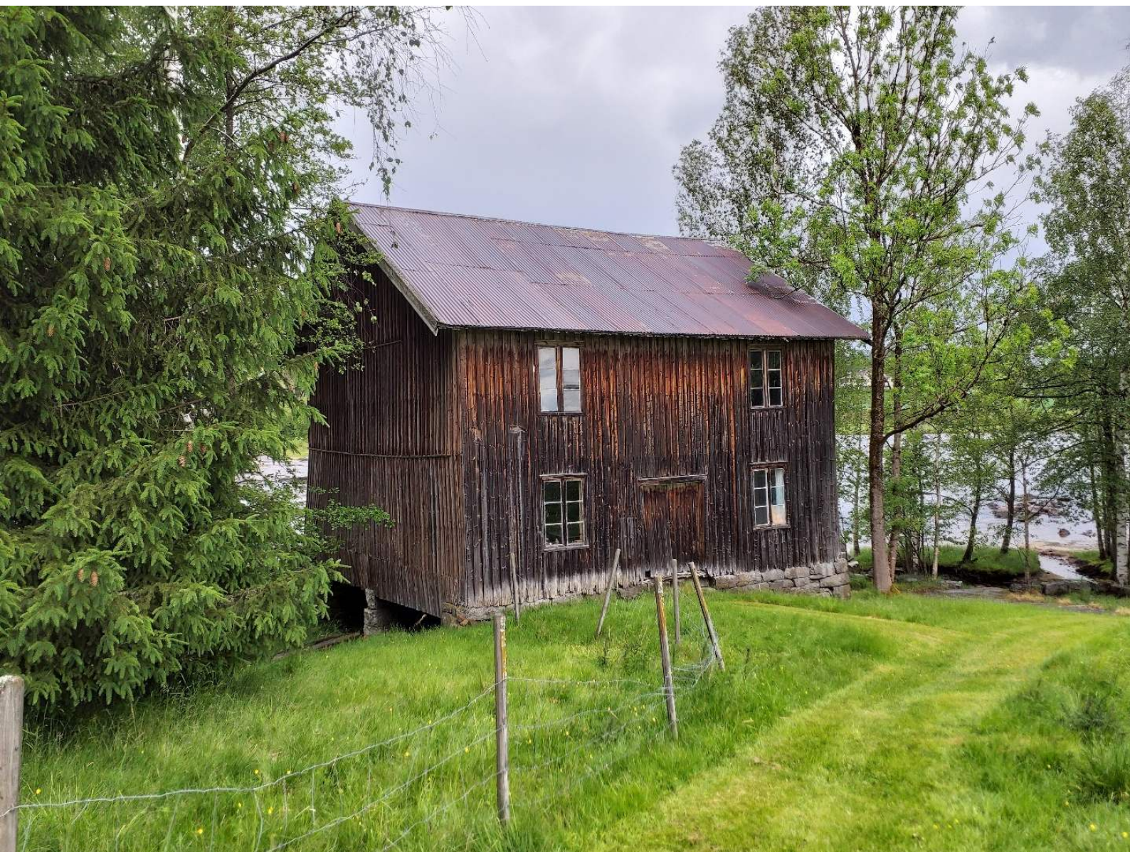
Figur 4-40 Dette kvernhuset (165690672) fra 1800-tallet tilhører bygningskategorien "Andre hustyper", og ligger vakkert plassert ved bredden av Bøelva. Bygningen er intakt. Foto: AH/Asplan Viak, 2025.
