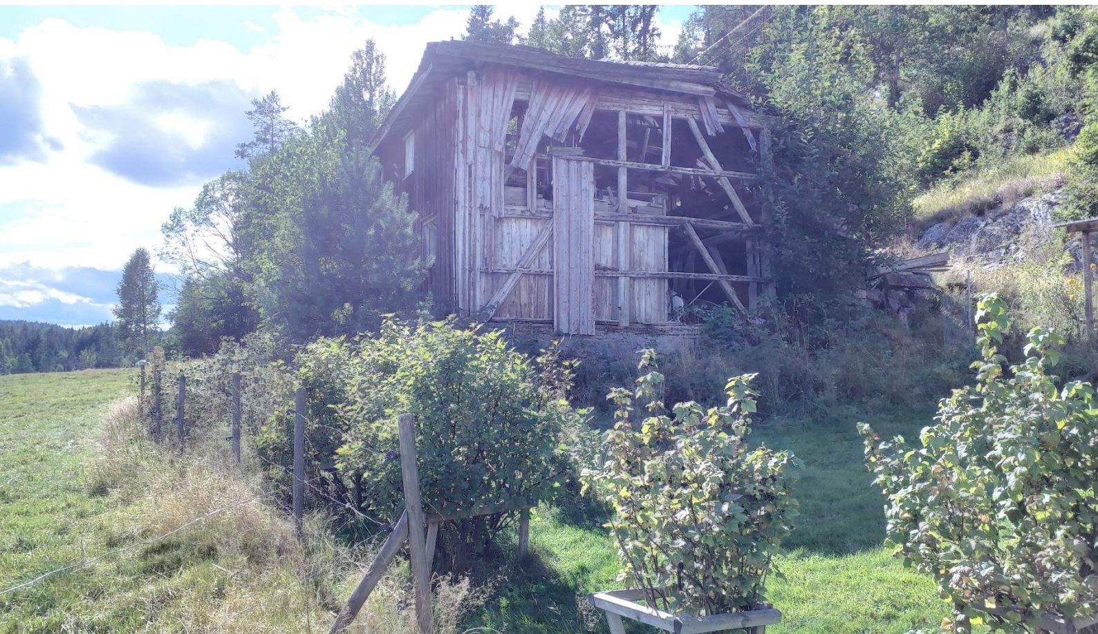
Figur 4-13: 8 av de registrerte bygningene i Gjerstad er sterkt truet. «Mindre uthus» og «Driftsbygninger i tunet» er de to bygningskategoriene som er mest truet av forfall og tap i Gjerstad i 6. omdrev. Øverst: Industribygg på Stifoss, Fiane. Foto: HT/Asplan Viak 2024. Nederst: Et uthus på Hovet, Sundebru hvor forfallet er sterkt fremskredent. Foto: MMS/Asplan Viak 2025
